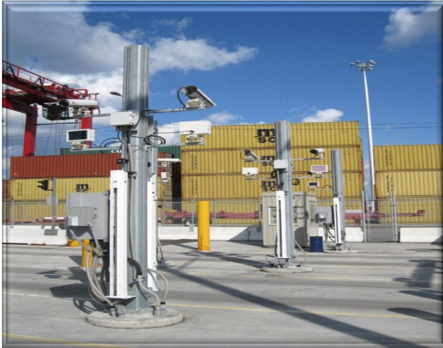
Figure15 : Capture des données et de position des conteneurs
